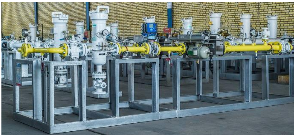
شکل (۳-۶) نمونه‌ای از ایستگاه‌های تقلیل فشار گاز
