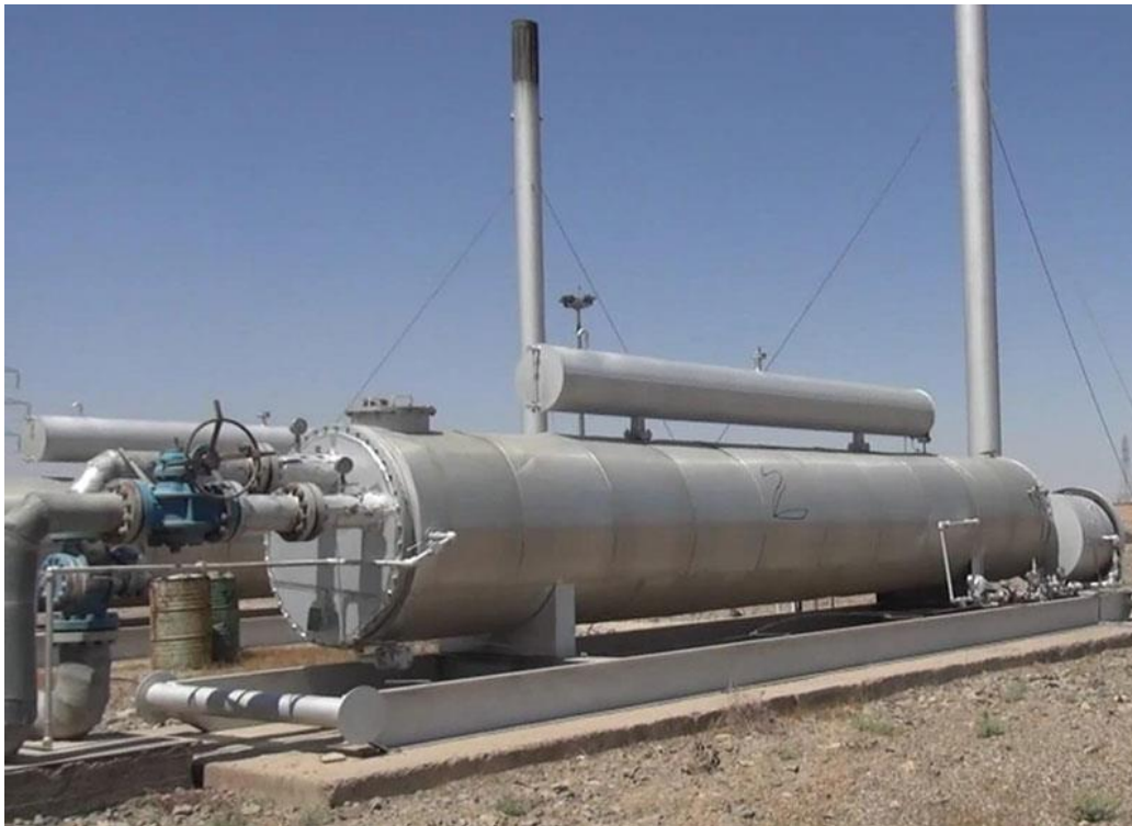
شکل (۶-۱۱) هیترهای ایستگاه‌های تقلیل فشار گاز
