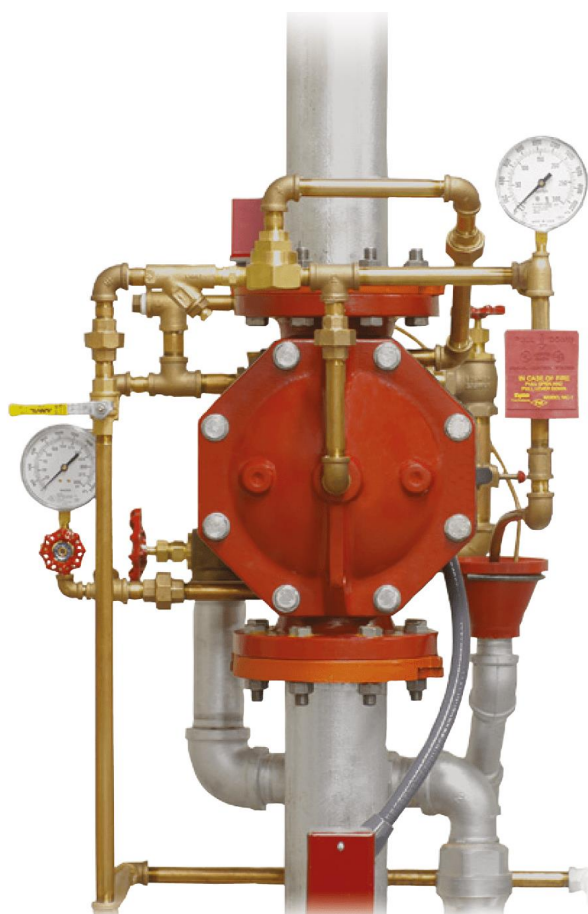
شکل (۶-۱۷) نمونه‌ای از شیرهای سیستم سیلابی
