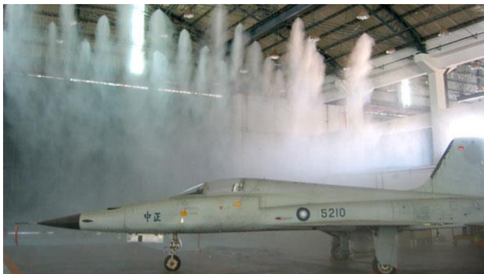
شکل (۲۳-۶) نمونه‌ای از کاربرد سیستم‌های مه آب در صنایع هواپیمایی
