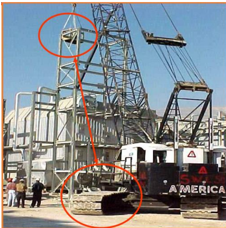
شکل (۴۱-۶) عدم استفاده از Crawler Crane ها برای کار با بسکت
